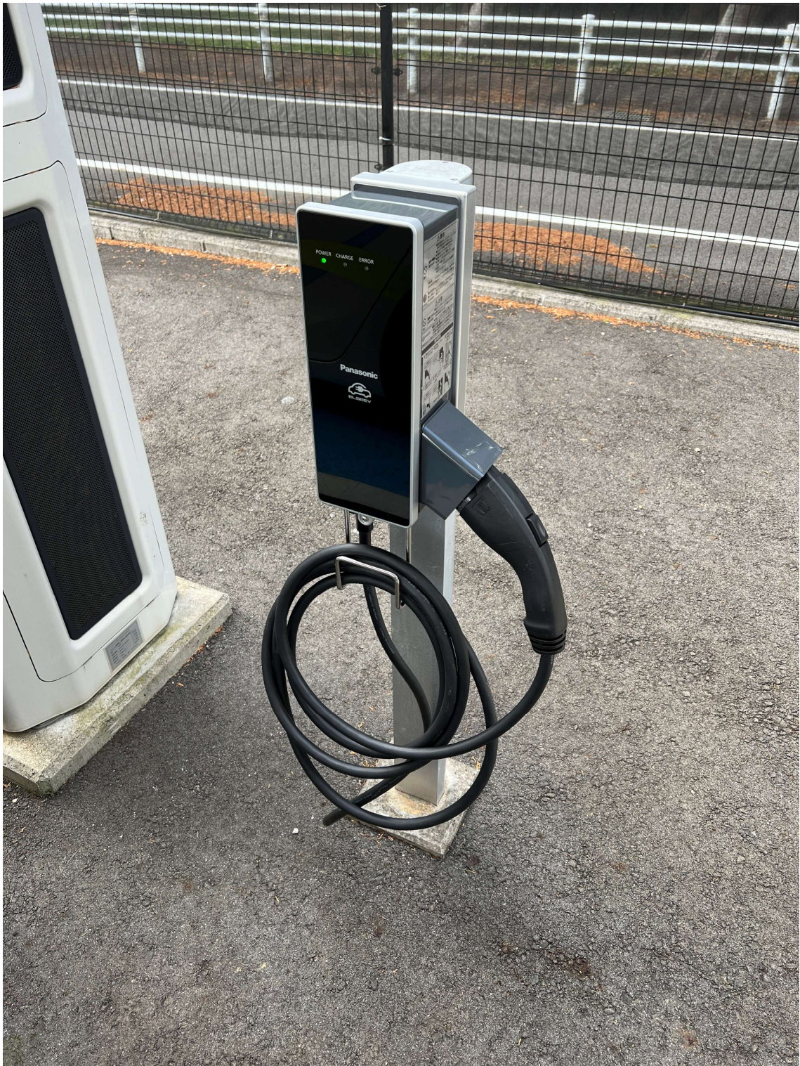
6kW普通充電設備 パナソニック製DNH326 1基
